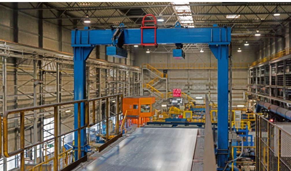
Das System am Einlauf der Kontibeize ist zwischen dem S-Rollensatz und dem Prozessteil installiert (Foto: Salzgitter Flachstahl)
